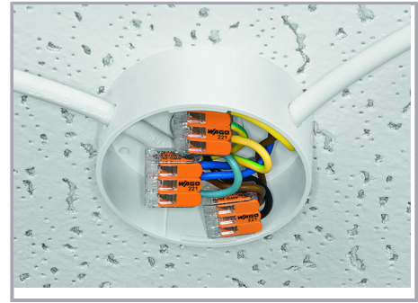
Leuchtenverteilung in Deckenbaldachin
